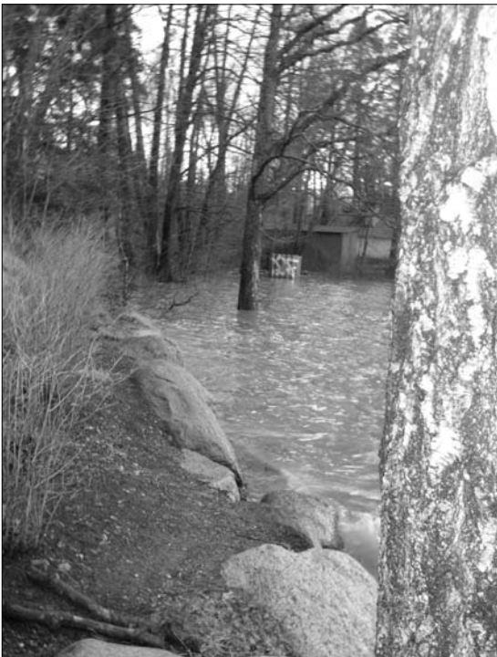
Tulvavesi on syövyttänyt pengerrystä Jupperinrannassa. Talkooporukalla riittää taas puuhaa
